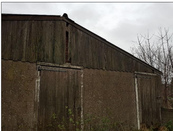
Figuur 9. Achterzijde vervallen stal (plangebied 2)
