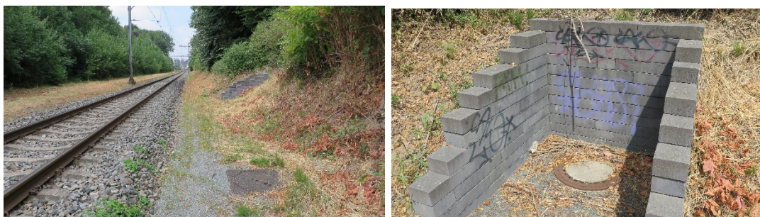
Figuur 3-1 Infiltratieputten tussen spoor km 19.2 en 19.4
