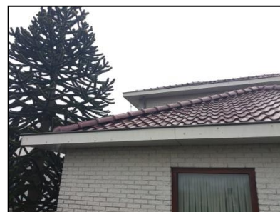
Figuur 11. Detailopname dak, waar veel nesten onder de nokpannen zijn waargenomen (datum foto: april 2018).
