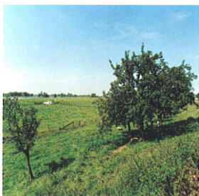
Erosie van het dijktaalud
