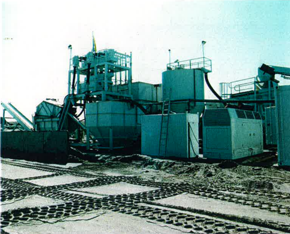
Figuur 5.11. Overzicht van de op de Slufter gebruikte zandscheidingsinstallatie.
