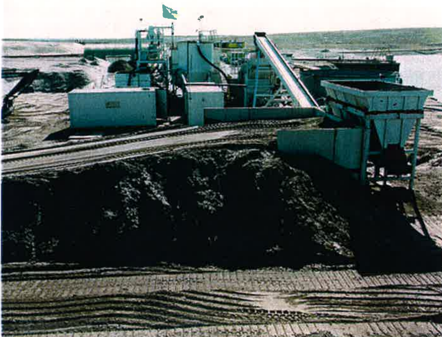
Figuur 5.10. Overzicht van de op de Slufter gebruikte zandscheidingsinstallatie.
