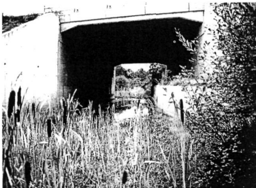
Foto [1.6.2] 3 Onderdoorgang van een waterloop in combinatie met een onverharde loopstrook voor fauna. De loopstrook voor fauna is gecreëerd met behulp van perronwanden (foto: H. Bekker)
