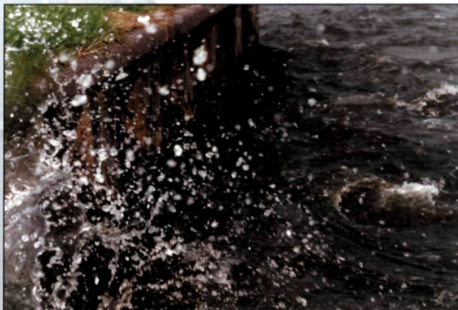
Foto 8.1: Opspattend water bij stalen damwand
