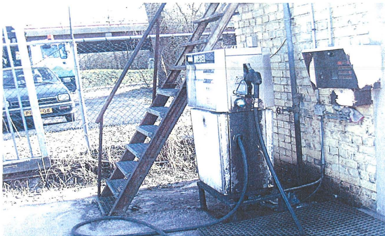
Foto 19: Zuiderdijk 82, dieselpomp van Keulen
