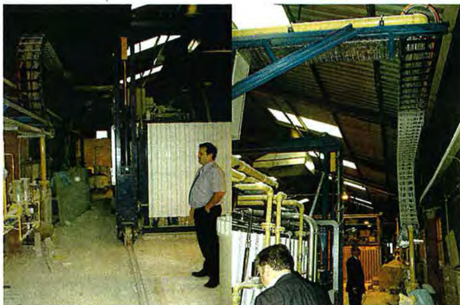
Foto 4.1: Voorbeeld van flexibele aansluiting van de voorzieningen aan de stolpoven en hydraulische zuigers van de deuren.
