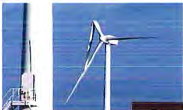
Figuur 4.4: Schade door blikseminslag bij Blyth Harbour (UK) (ECN, 2002)
