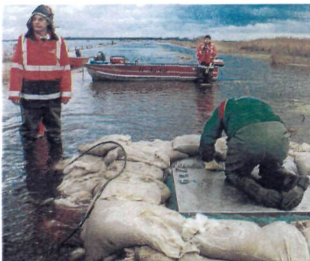
Afbeelding 1. Inundatie puttenveld pompstation Onnen (1998)
