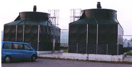
Foto: koeltorens bij een tuinbouwproject voor het herstellen van de energiebalans.
