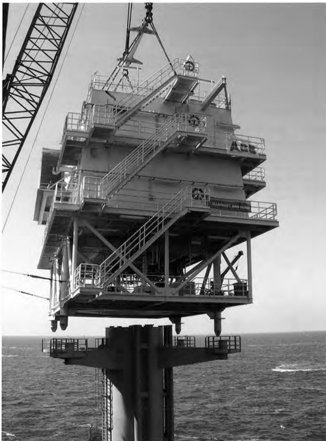
Afbeelding 3-5 Voorbeeld van een offshore transformatorstation (bron: Offshore windpark Q7)
