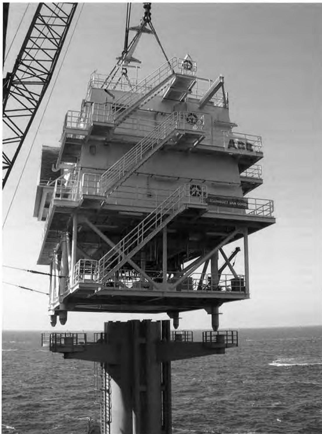
Afbeelding 3-3 Installatie transformatorstation (bron: windpark Q7)
