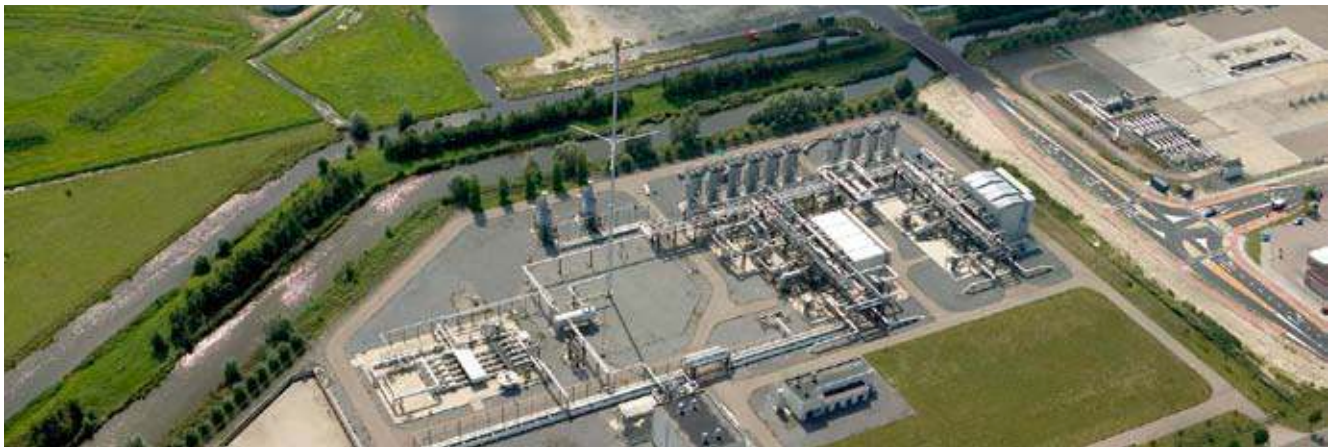
Figuur 7: De vergelijkbare installaties van de PGI
