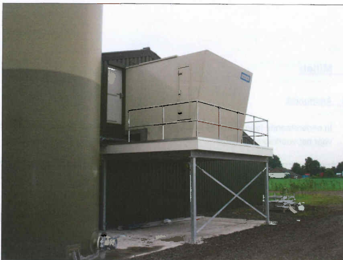
Figuur 22: gecombineerd luchtwassysteem
