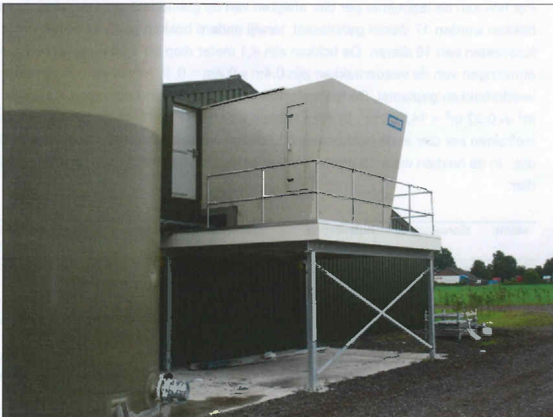
Figuur 22: gecombineerd luchtwassysteem
