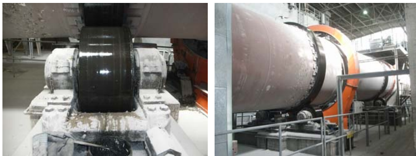
Olie en vet t.b.v. het aandrijfmechanisme van de installatie
