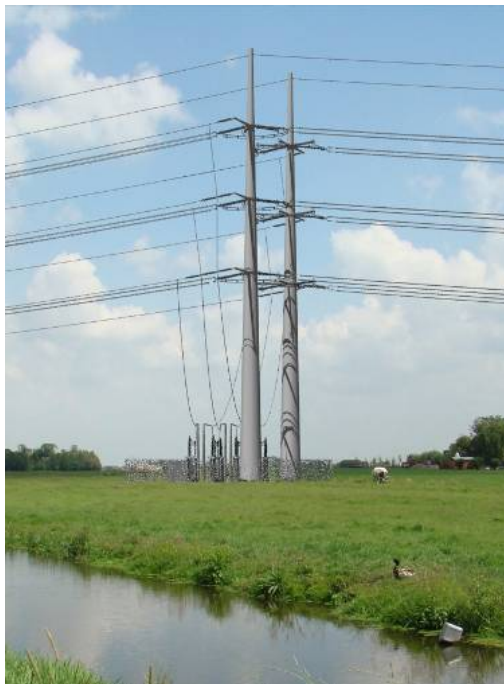
Foto 21: Impressie opstijgpunt 150 kV bij een Wintrackmast
