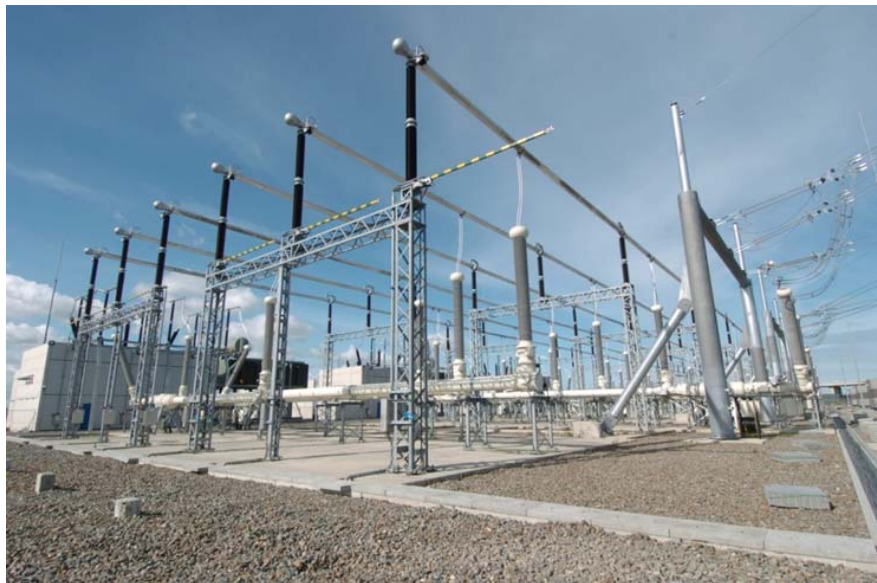
Foto 17: Impressie van een veld met schakelapparatuur
