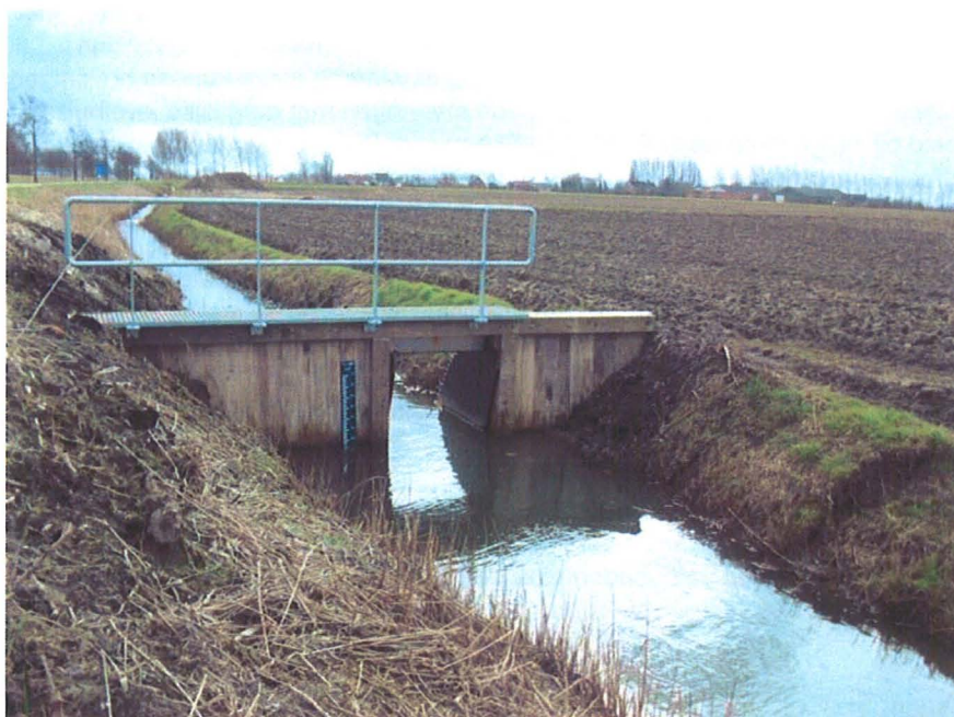
Figuur 6.6. Peilregulerende stuw deel Noordhofpolder
