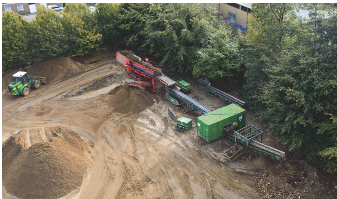
Fig. 4.4: De zeefinstallatie van Armaex
