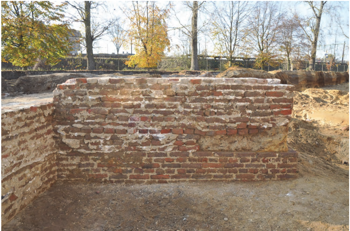
Fig. 7.12: Steunbeer van de zuidelijke face MD8 van bastion 2: fase 1b slordig gemetseld op fase 1a, deels op zandlaag.
