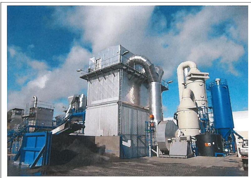
Foto 4: overzicht uitvoerzijde gereinigd materiaal, doekfilter, ventilator 2 en gaswasser
