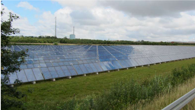
Figuur 15. Zonnepanelen in de wei (Duitsland)
