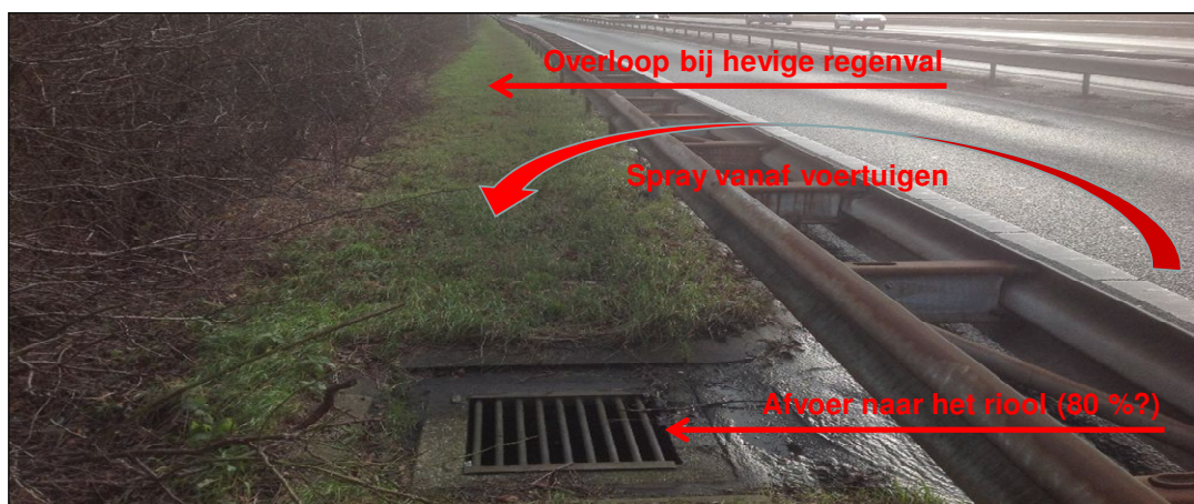
Afbeelding 16 Afvoerput hemelwater binnen plangebied (hoofdrijbaan rechts, buitenberm)
