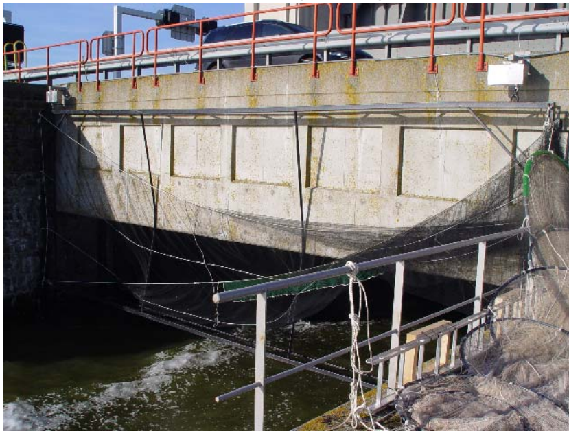
afbeelding IV.1. Vangconstructie in koker 16 na beschadiging. Zichtbaar zijn het raamwerk, de fuik en de verlengde vleugels
