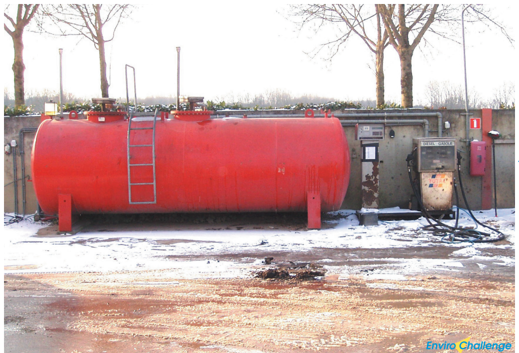
Illustratie 12 : Dieselopslag in bovengrondse stalen tank met brandblusmiddel (onderhoudslijn)
