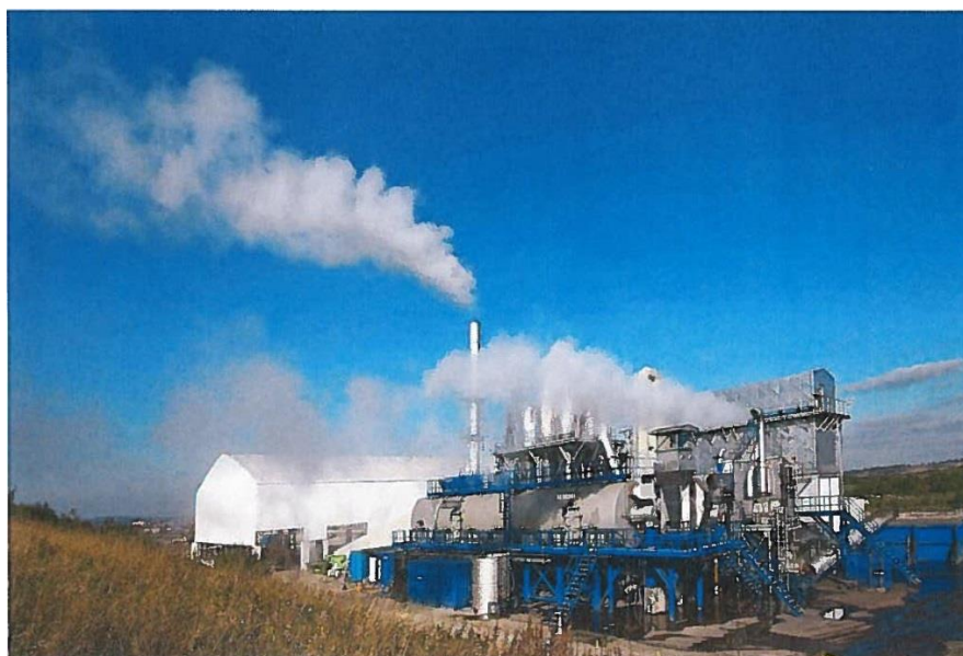
Foto 2: thermische reinigingsinstallatie locatie Chesterfield (UK)
