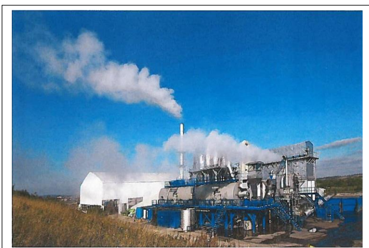
Foto 2: thermische reinigingsinstallatie locatie Chesterfield (UK)
