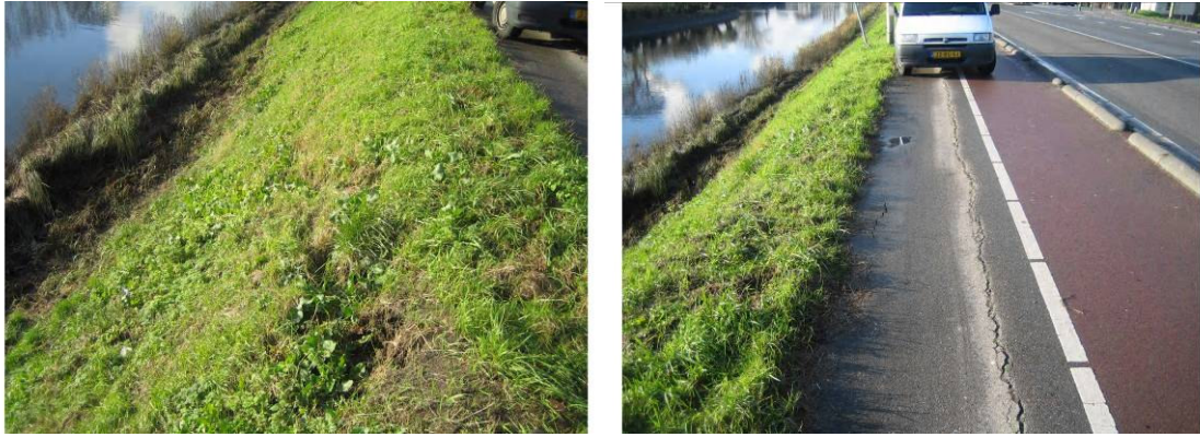
Figuur 3-1: Verzakking ten gevolge van instabiliteit Goejanverwelledijk
