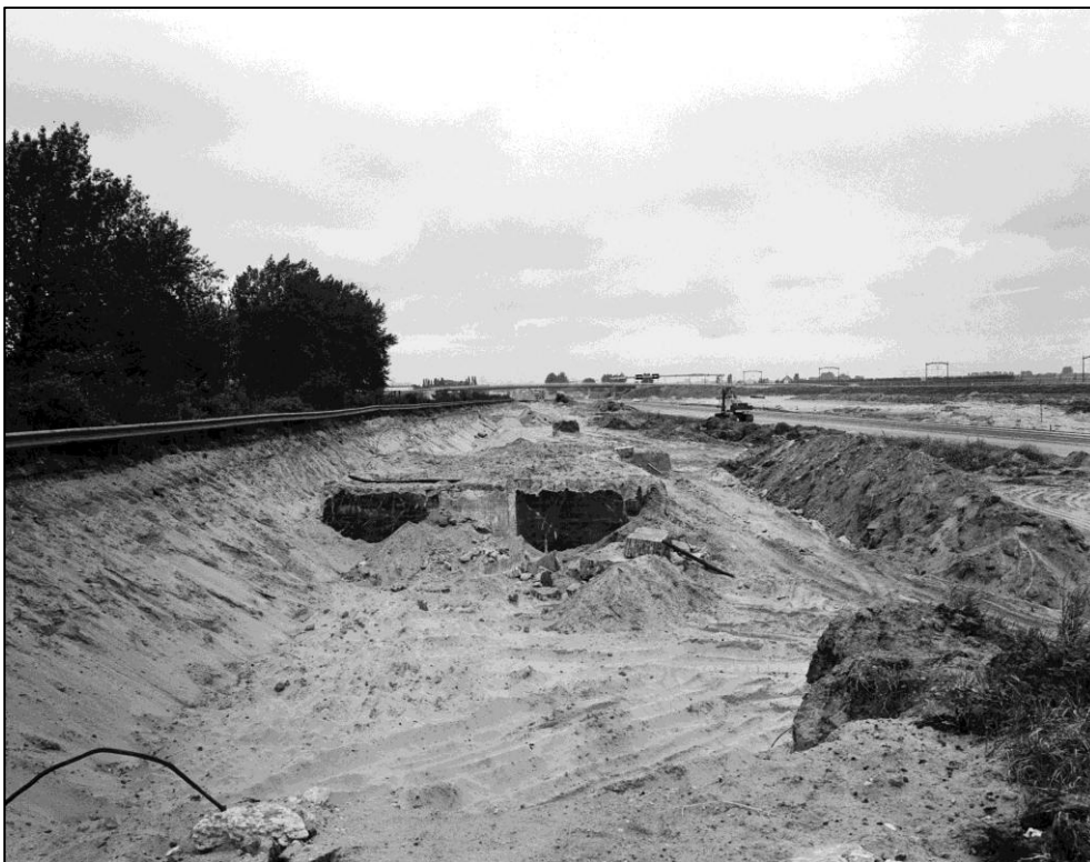
Figuur 33: Beeldmateriaal met een impressie van de naoorlogs uitgevoerde werkzaamheden in het onderzoeksgebied. De beelden tonen bodemingrepen naar aanleiding van de voorgenomen verbreding van de huidige A16. Bron: https://beeldbank.rws.nl
