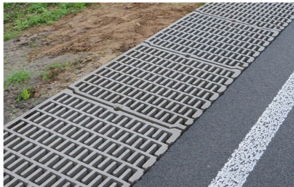
Voorbeeld van een innovatieve geluidsmaatregel/ diffractoren
