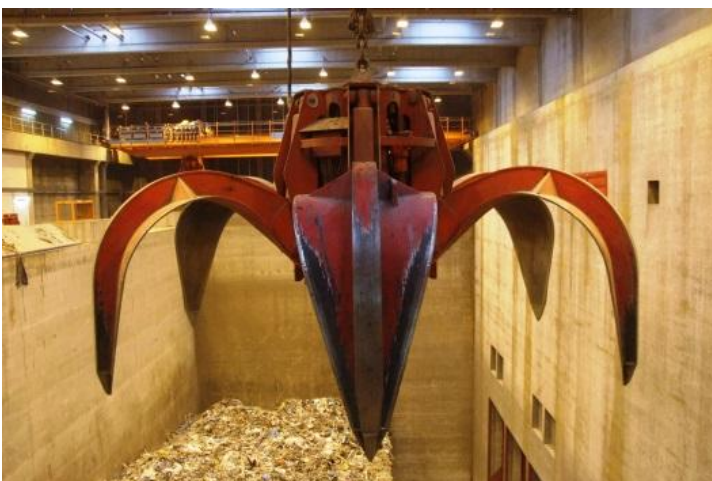
Figuur 9: Bunker met grijperkraan
