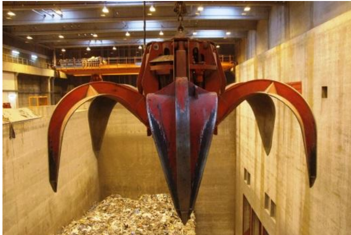
Figuur 20: Bunker met grijperkraan
