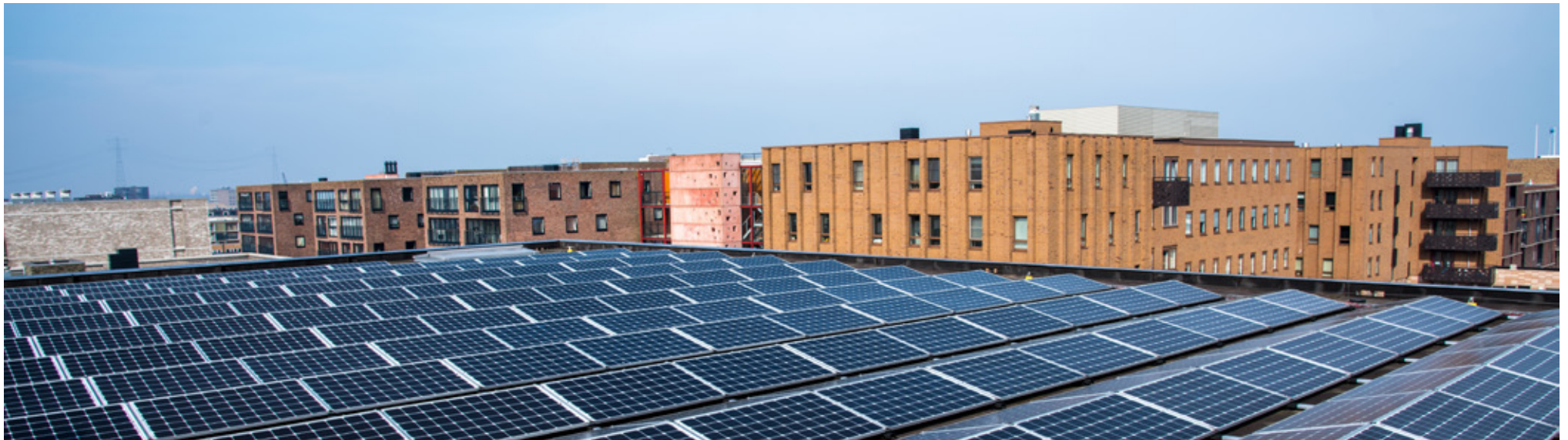
Afb. 8.5 Zonnecollectoren op dak IJburg College, Amsterdam Oost
