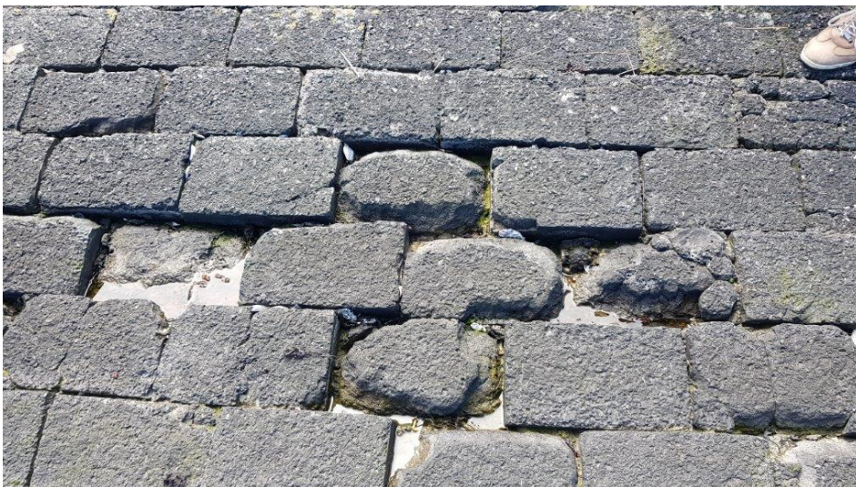
Figuur 7: Impressie van de schade en verouderingsproces aan de koperslakblokken
