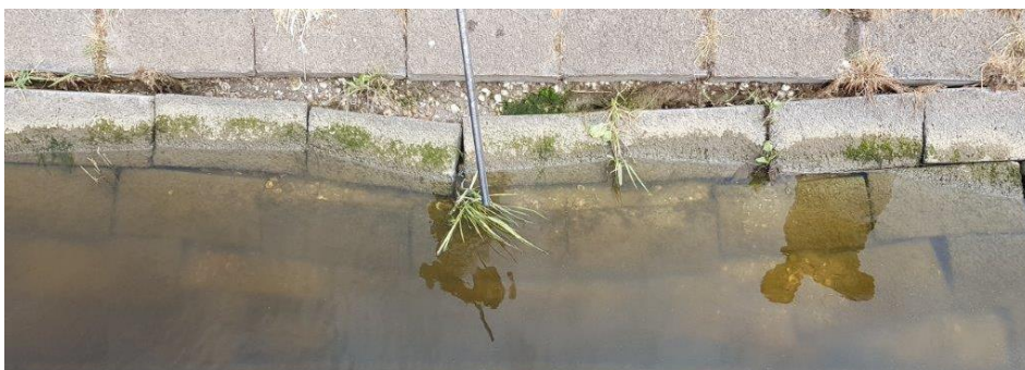
Figuur 3 Verzakking van de bekleding op het binnentalud bij de jachthaven van het Lauwersmeer
