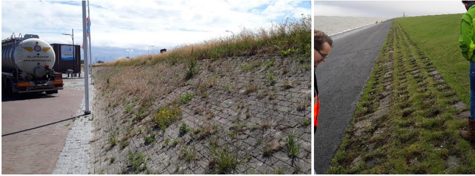
Figuur 6: Impressie klinkers bij dijkpaal 90.0 – 90.5 (links) en betonblokken buiten de haven van Lauwersoog (rechts)
