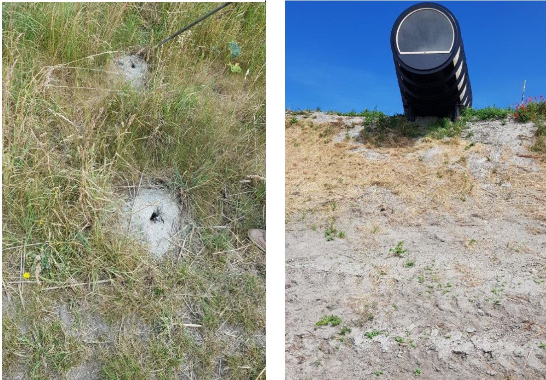
Figuur 10: Grasbekleding op het binnentalud (links) en ontbreken van de bekleding bij dijkpaal 89.9 (rechts).
