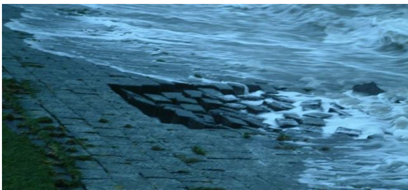
Figuur 8: Schade aan de koperslabblokken op het dijktraject 6-5 tijdens de Allerheiligenvloed van 2006
