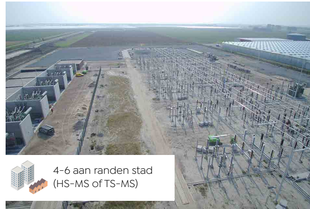
HS-MS station (van 110-150 naar 3-23 kV)
