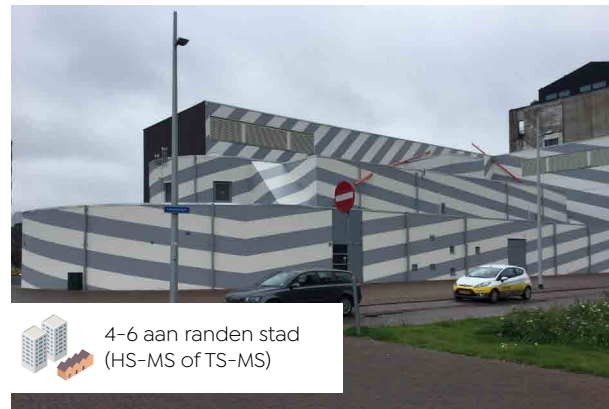
TS-MS station (van 25-66 naar 3-23 kV)
