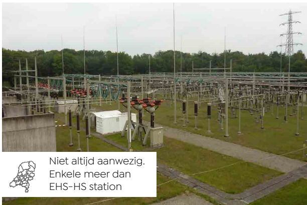
HS-TS station (van 110-150 naar 25-66 kV)
