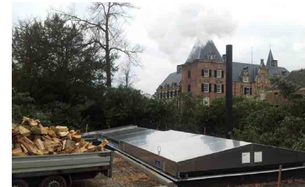
biomassaketel op lokaal (snoei)hout
