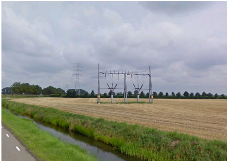
Aandachtspunt: hoogspanningsmast direct ten noorden van terminal
