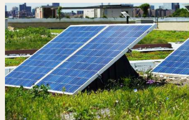
Zonnepanelen op sedumdak
