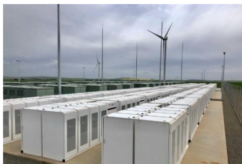
Figuur 7.1 Lithium-Ion batterij complex Australië (450MWh)
