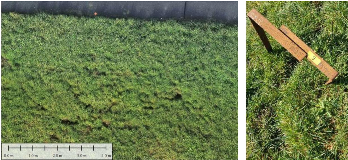
Figuur 2.6: Scheurvorming in grasbekleding binnendijks
