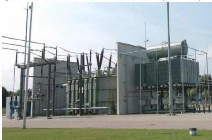
Figuur 5.2 Voorbeeld transformator in een transformatorcel (scherfmuren)
