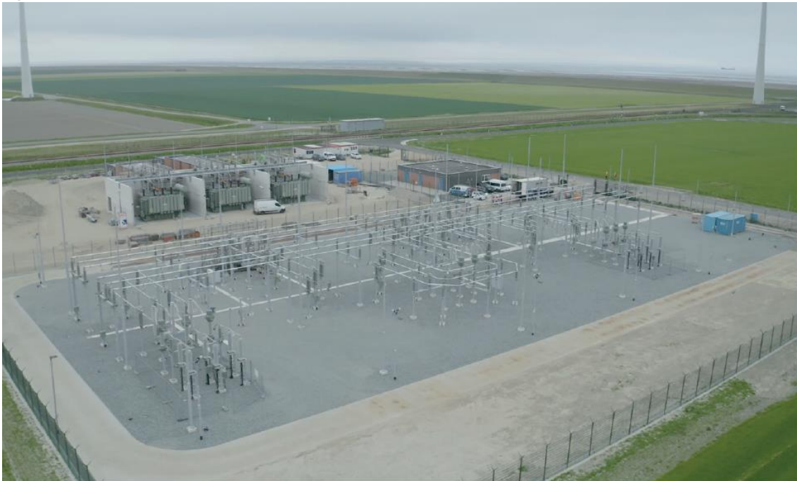
Figuur 4.5 Voorbeeld HS-station
