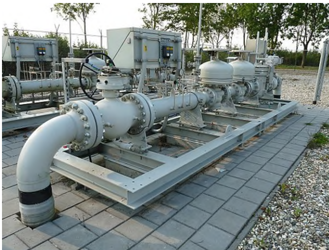
Figuur 3-10 Foto van een meet- en regelstation voor aardgastransport. Van het waterstof gasontvangstation is nog geen ontwerp beschikbaar. Het waterstof gasontvangstation zal naar verwachting qua omvang, hoogte en zichtbeleving vergeleken kunnen worden met dit meet- en regelstation (Bron: HNS)
