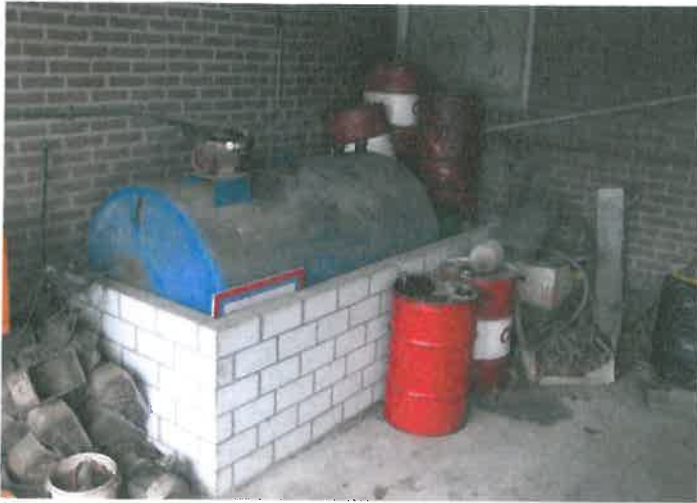
Foto 4: bovengrondse dieseltank (1.200 liter)
