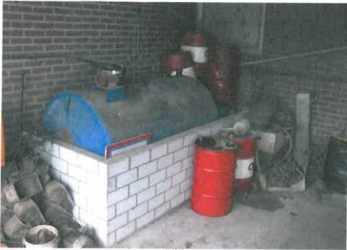
Foto 4: bovengrondse dieseltank (1.200 liter)
