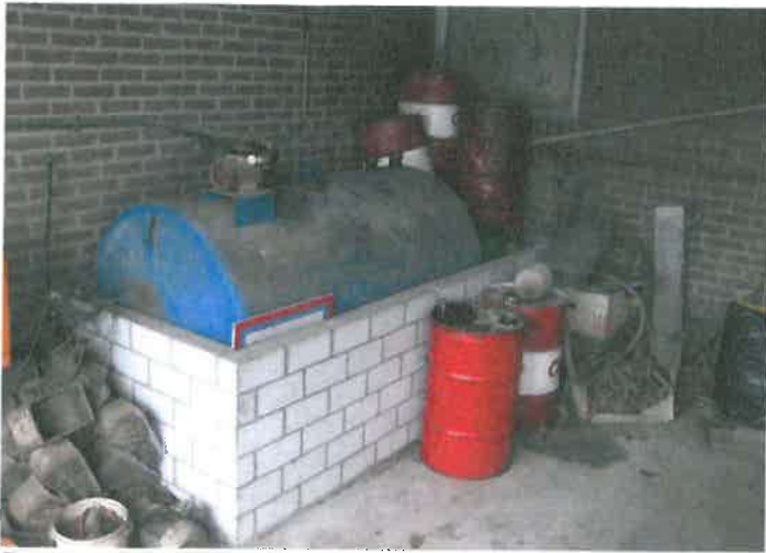
Foto 4: bovengrondse dieseltank (1.200 liter)
