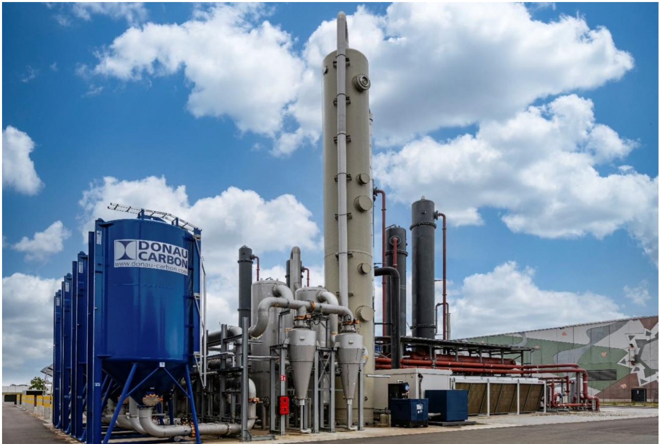
Figuur 2-1 Biogasopwerking en actief koolfilters Bio Energy Coevorden BV (bestaande situatie)
