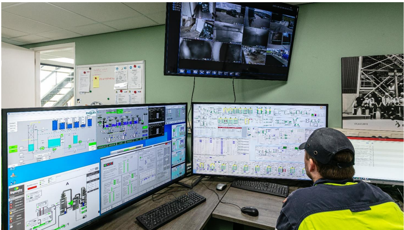
Figuur 3-1 Controlekamer Bio Energy Coevorden (bestaande situatie BEC)
