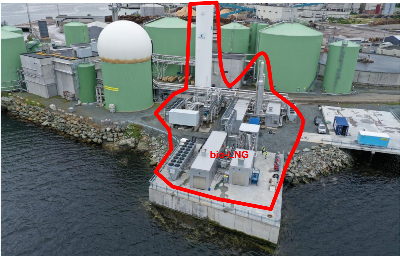
Figuur 2-2 Voorbeeld van een bio-LNG installatie bij de vergistingsinstallatie in Skogn, Noorwegen
