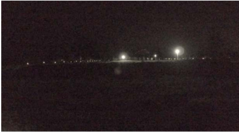
Afbeelding 6: verkeerd afgestelde lichtmasten op het parkeerterrein.
