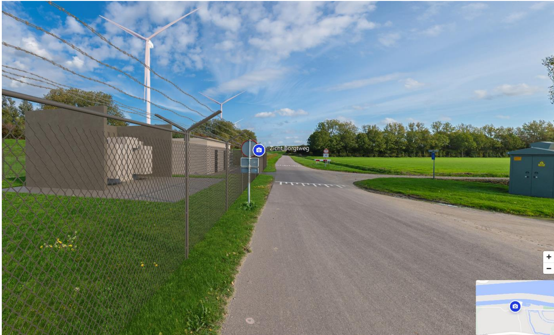
Figuur 34. Onderstation met transformator, met op de achtergrond WT4 t/m WT6.
