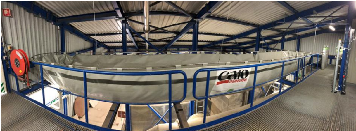
Figuur 19, Afvang installatie, CO 2 buffer gaszak op 5e verdieping RGR gebouw BEC
