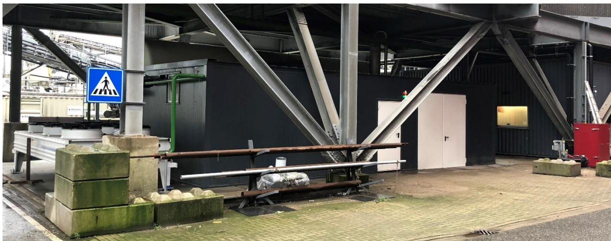
Figuur 8, behuizing van de skid, met links de koelerbank en rechts (rood) aansluiting op CO 2 leiding
