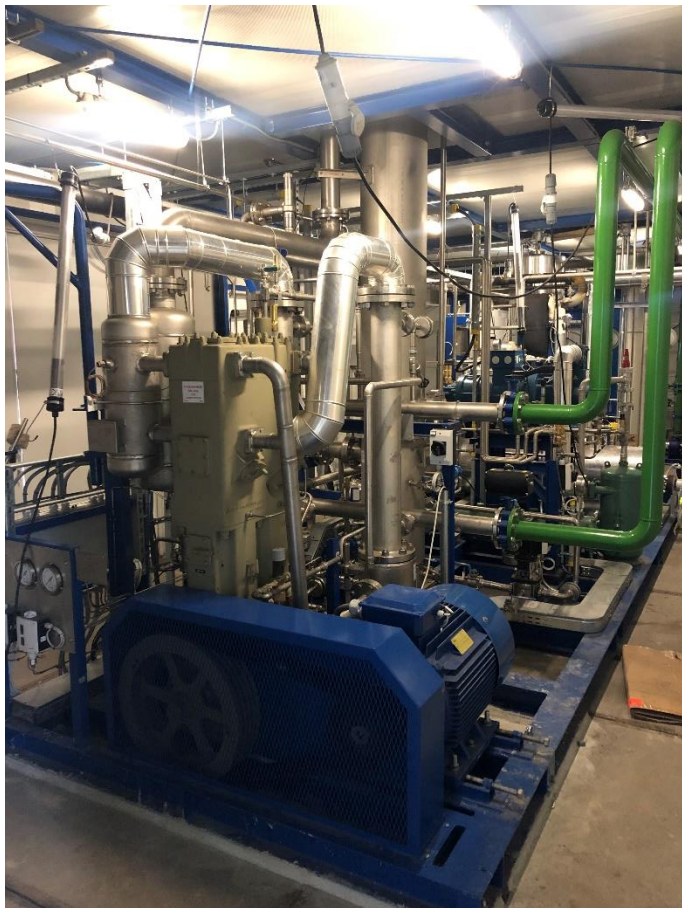
Figuur 11, skid van de vervloeiing gemonteerd en al in de behuizing
