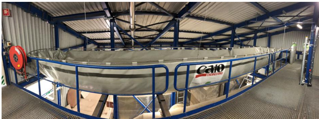
Figuur 19, Afvang installatie, CO 2 buffer gaszak op 5e verdieping RGR gebouw BEC
