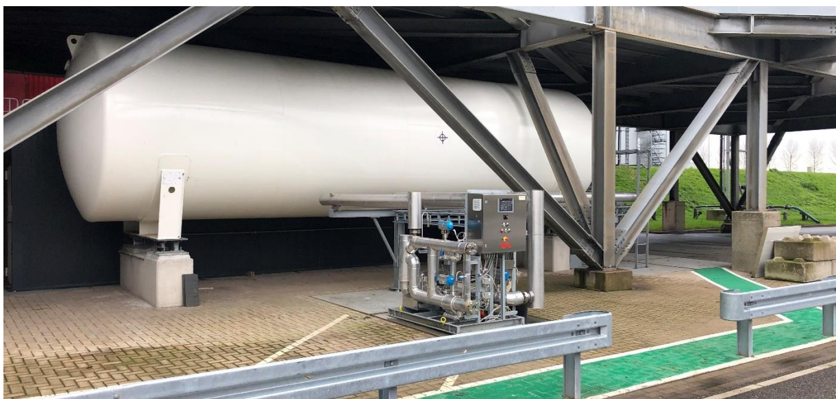
Figuur 10, Opslagtank LCO 2 met verladingsstation en aanrij beveiliging (vangrail)
