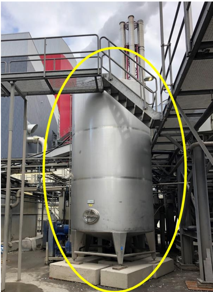
Figuur 20, diffuser tank voor het oplossen van de CO 2 in BAWI water
