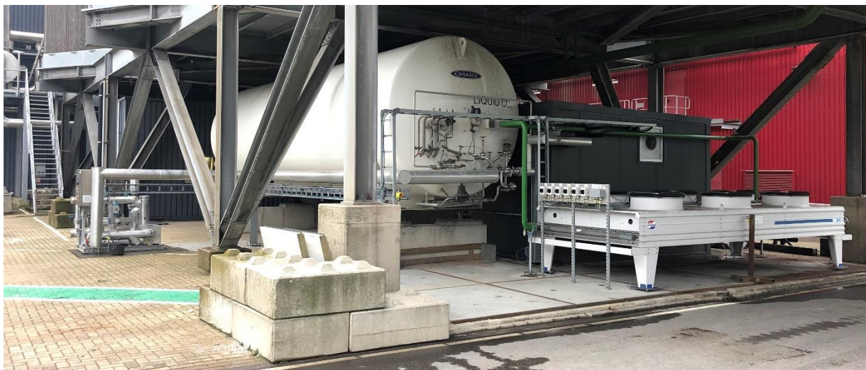
Figuur 9, rechts koelerbank voor de behuizing van de vervloeiing en de opslagtank ernaast (links)
