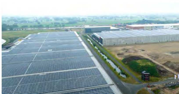
Zonnepanelen op het dak zijn op XL Businesspark 1 al massaal toegepast. De teruglevering aan het net is een probleem
