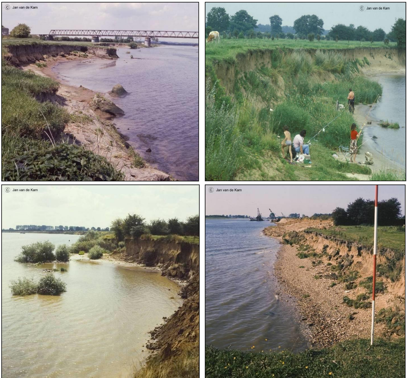
FIGUUR 3.9 BEELDEN VAN DE MAASOEVERS VAN ROND 1974 BIJ GENNEP (LINKSBOVEN), BOXMEER (RECHTSBOVEN), OEFFELT (LINKSONDER) EN KESSEL (RECHTSONDER). DE FOTO BIJ KESSEL TOONT DE OEVERWERKZAAMHEDEN IN UITVOERING WAARBIJ HET OEVERTALUD ONDER EEN VASTE HOEK WERD AFGEWERKT EN VERSTEVIGD MET AANVANKELIJK VAAK GRIND, LATER BREUKSTEEN (FOTO'S JAN VAN DE KAM).
