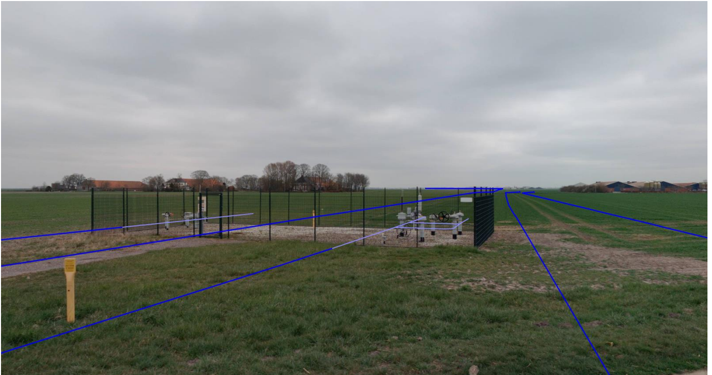
Figuur 3-2 Voorbeeld bestaande afsluiterlocatie voor aardgas S-135 Oostwold. De blauwe lijnen geven aan waar ondergronds de aardgasleidingen liggen
